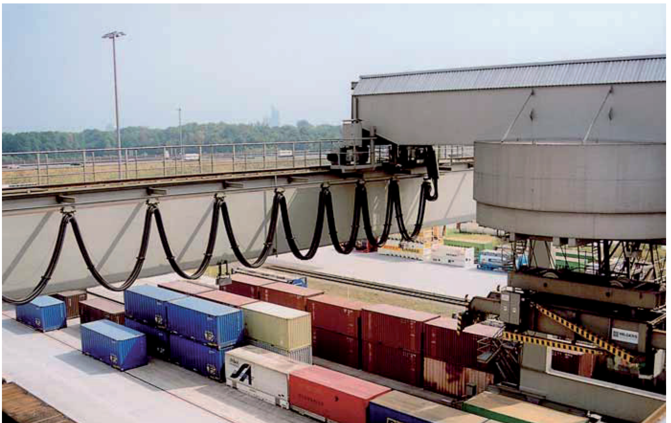
Leitungswagenanlage an einem Containerkran
